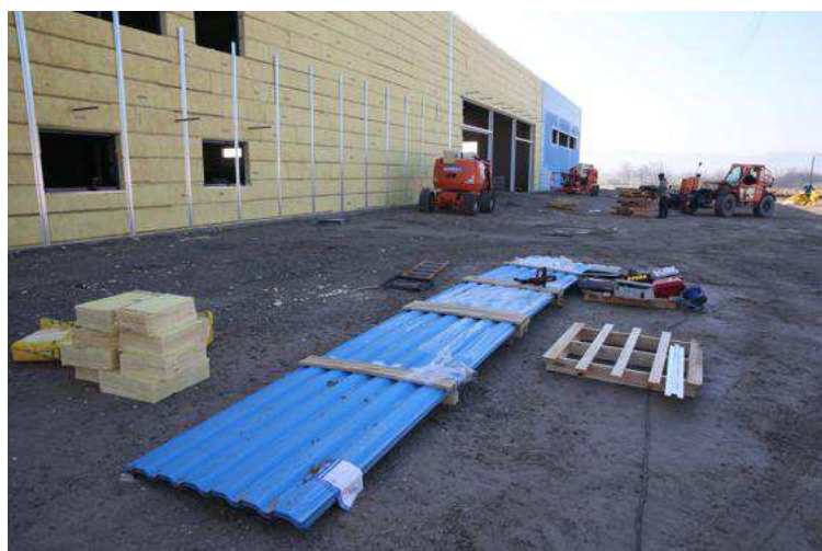
L'imposante construction de 3 000 m 2 qui abritera BricoCash est en cours d'isolation et de bardage.
